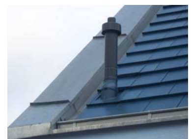
Thermen-Entlüftung über Dach
