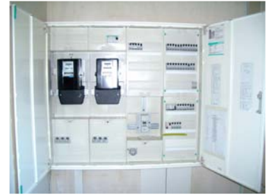
Elektroschrank ( zwei Plätze ) Unterverteilung, Sicherungs- automaten, und FI-Schalter
