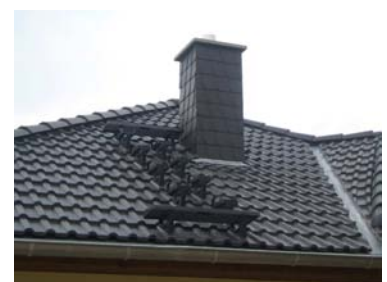
Schornstein mit Laufanlage
